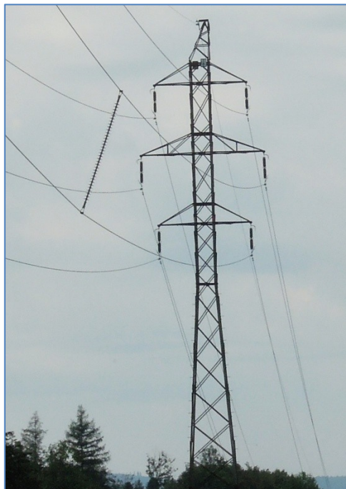
Dvojité vedení 110 kV
