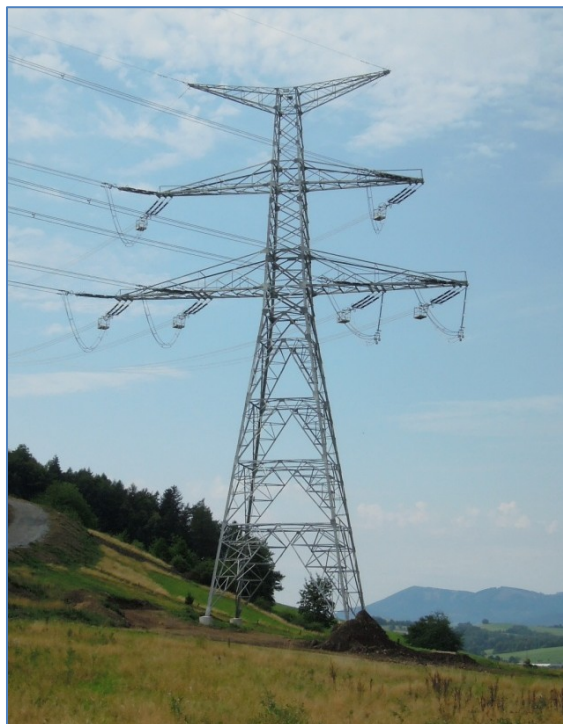
Dvojité vedení 400 kV
